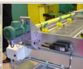
En bout de rangée, le moteur de commande de la vis d'alimentation (en vert) et le bloc (noir) portant le vérin de commande des trappes horizontales de la rangée.
